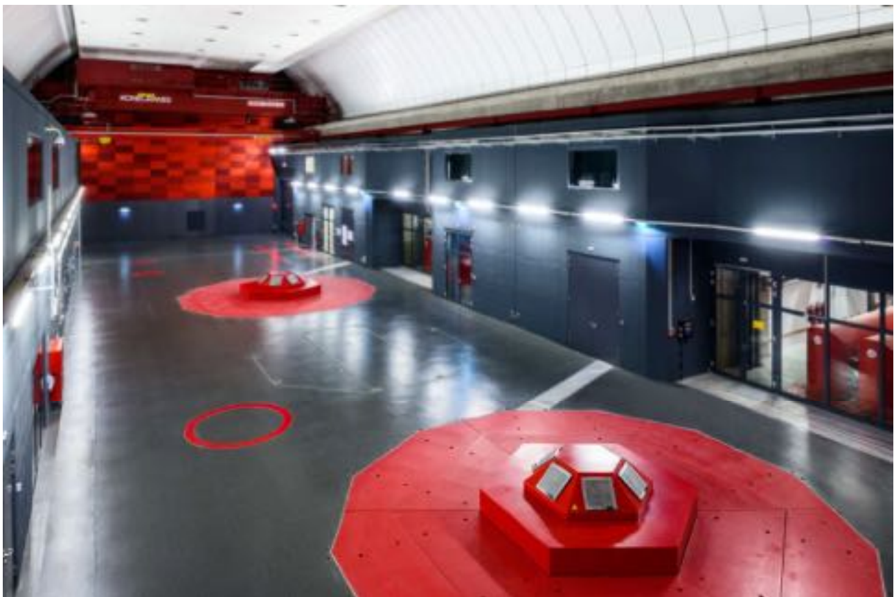
Abbildung 14: Neues Pumpspeicherkraftwerk Reißbeck II
